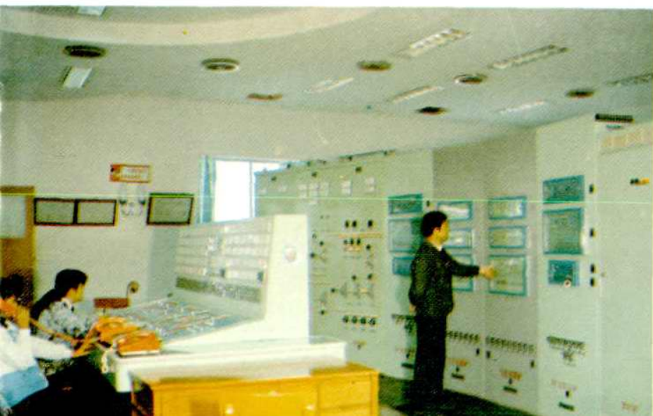
新建金城江变 电站中控室
