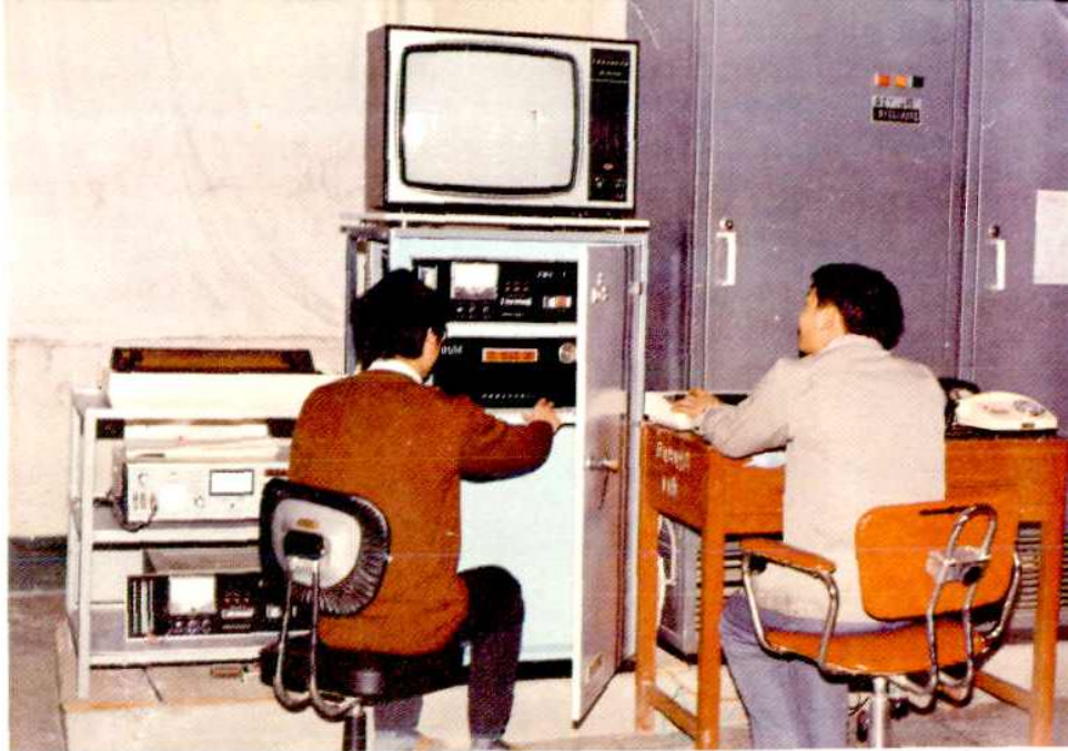
电力调度 运动装置
