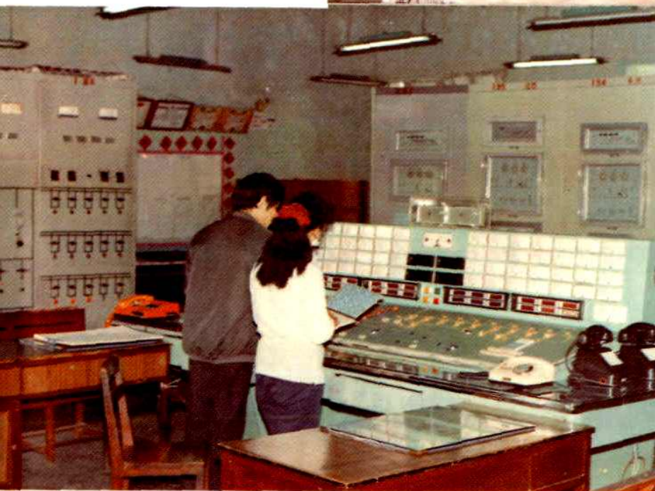
六圩220千伏 枢纽变电站控制室
