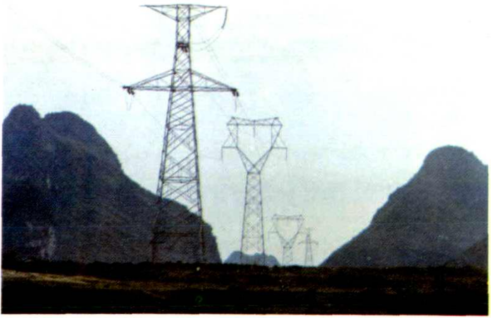
合山至金城江220千伏输电线路塔群
