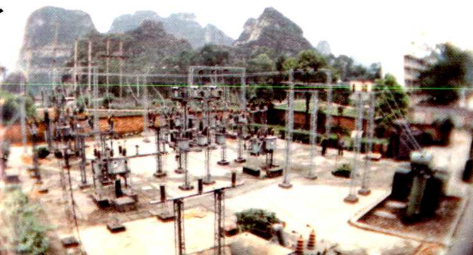
俯视老街变 电站
