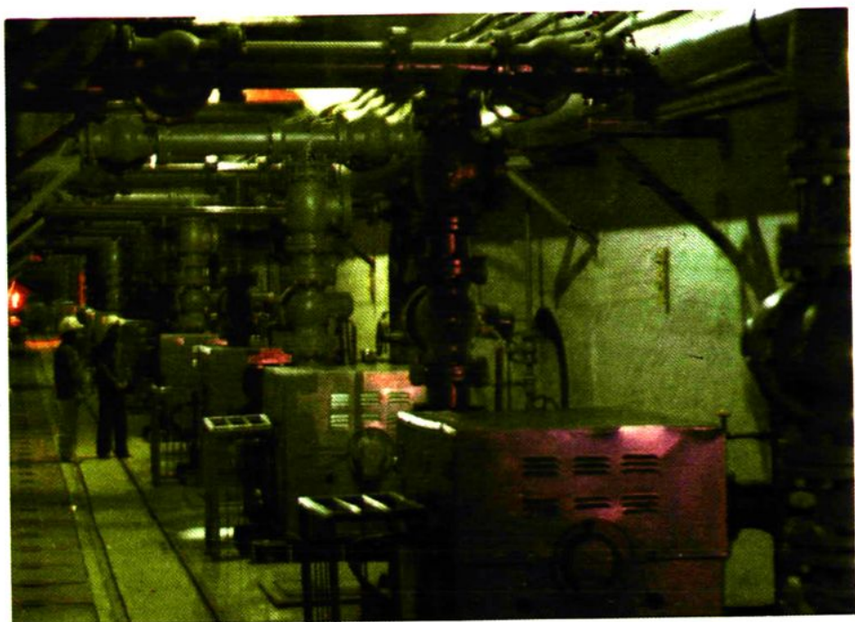
照 1 - 7 山东省第一座地下泵站—谷家台井下中央泵站
