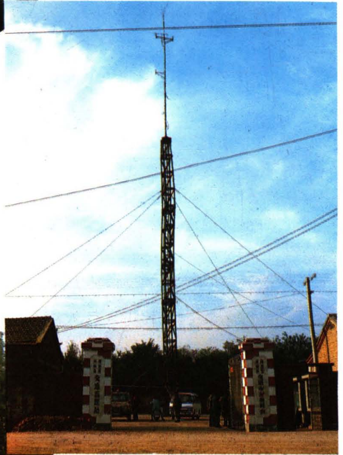
无线电二级 通讯网天线塔架
