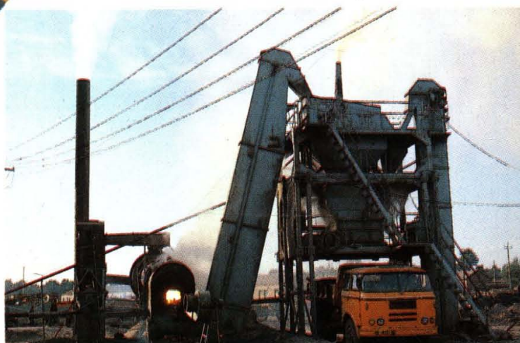
自动控制沥青混凝土拌合机
