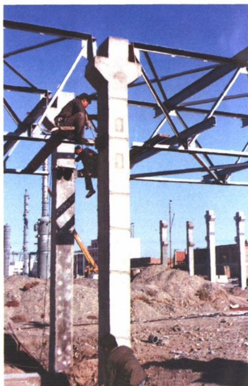
独山子乙烯厂区管架(1993年7月)
