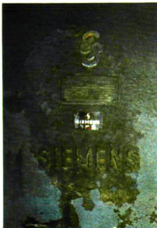
报废后的 1 号 发电机铭牌。
