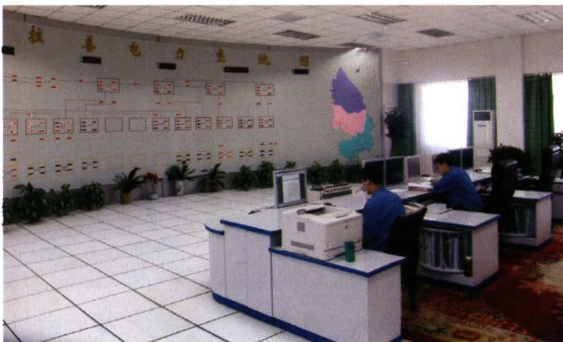
2004年8月, 建成的电网调度指挥中心
