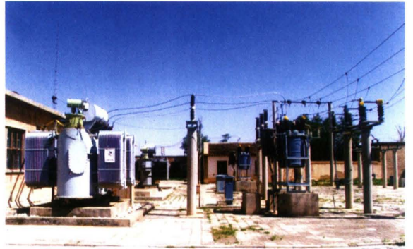
70年代建成的35kV腰坝变电站
