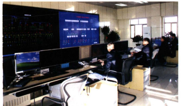
2013年6月, 建成的现代化电网调度指挥中心
