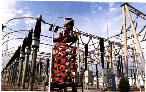
2004年1月12日, 阿拉善地区建成的第一座220kV电压等级变电站——乌斯太变电站
