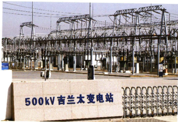
2005年8月17日, 阿拉善地区建成的首座500kV电压等级变电站——吉兰太变电站
