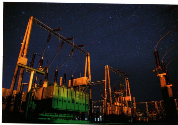
2008年3月, 蒙西电网最偏远最艰苦的黑鹰山110kV变电站, 距离内蒙古自治区首府呼和浩特1800多公里
