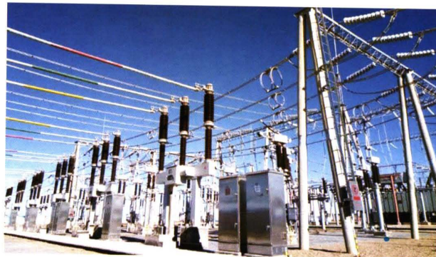
2015年10月31日, 220kV阿右旗变电站投运, 为综合自动化枢纽变电站
