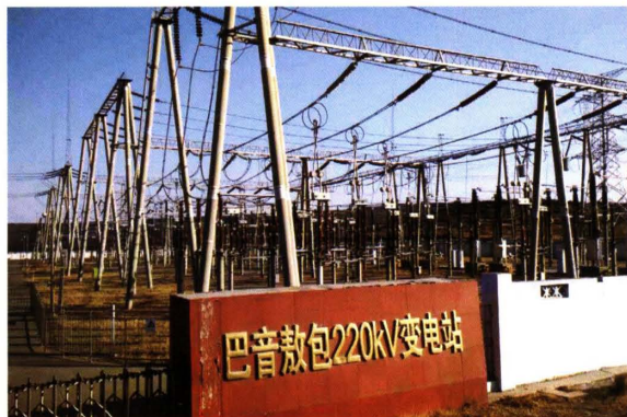
2010年7月，建成投运的220kV巴音敖包变电站
