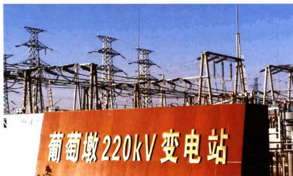
2012年7月，建成投运的220kV葡萄墩综合自动化变电站
