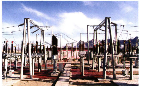
1996年11月30日, 盟府所在地建成的首座110kV巴彥浩特变电站, 蒙西电网第一次延伸至阿盟境内
