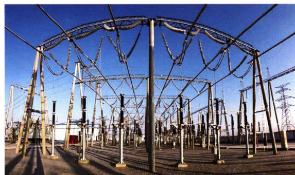
2016年1月，建成投运的220kV巴音毛道变电站
