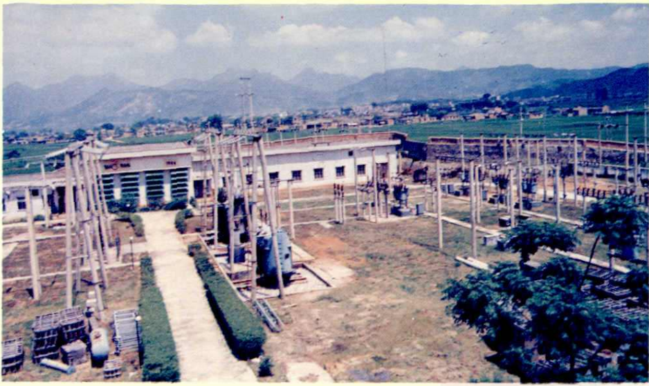
市供电公司 110 千伏变电站
