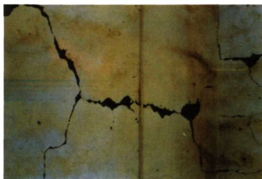
高桥 M L 3.6级地震时,震中区杨光千二层砖混结构房顶楼梯口垛子房墙体开裂
