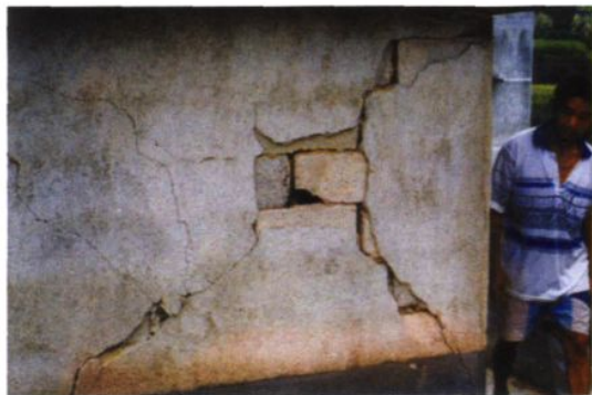
高桥 M L 3.6级地震时,震中区杨大林住房墙体开裂情况
