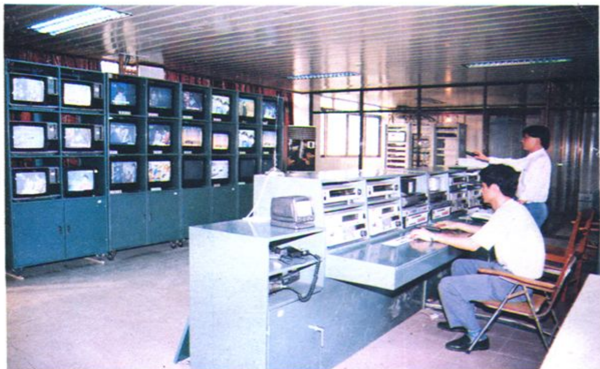
全新设备的梧州有线电视台播控中心
