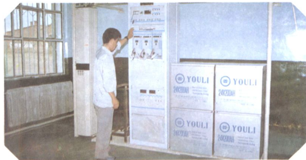
卜塔亥邮电所程控、电力综合机房
