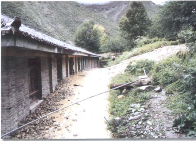
德钦县委党校泥石流灾害现场
