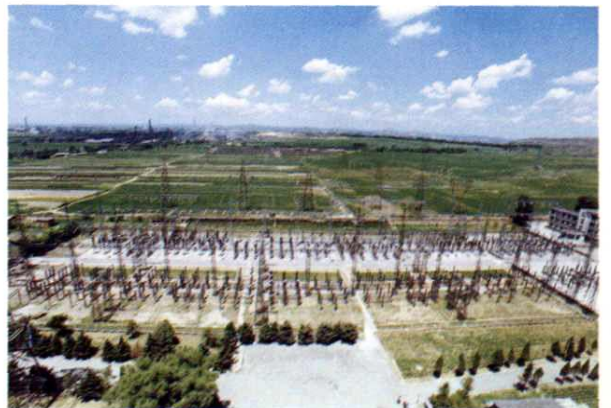
220 千伏李石寨变电所开关场全景
