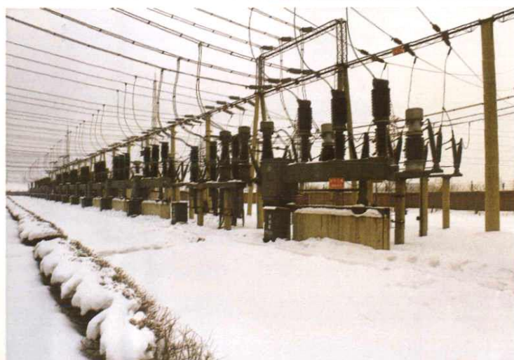
元龙变 66 千伏开关设备
