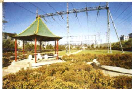
花园式变电所——和平变电所
