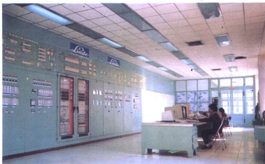
污水处理总控室
