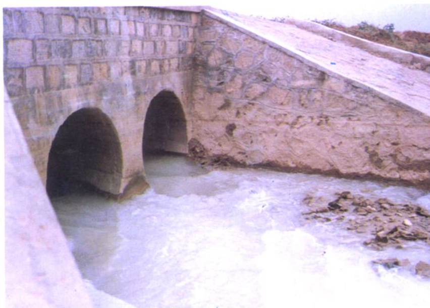
排海管线终点出口
