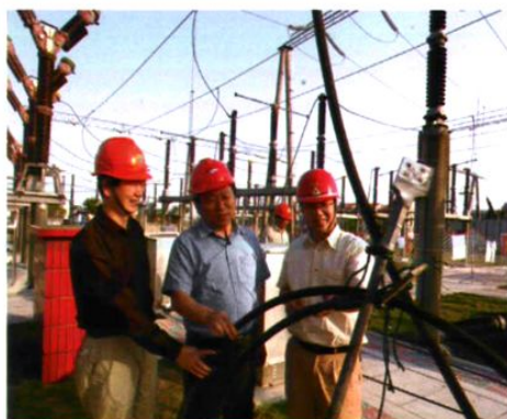
2007年5月，荆门供电公司副总经理余志华（中）现场检查变电所安全生产情况
