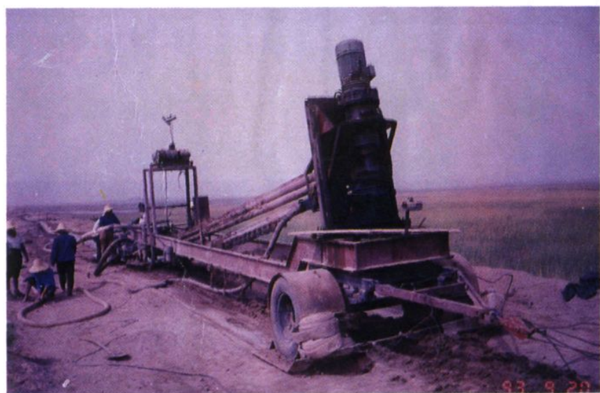
莒南县水利电力安装工程公司在新疆喀什红旗水库大坝铺塑防渗施工
