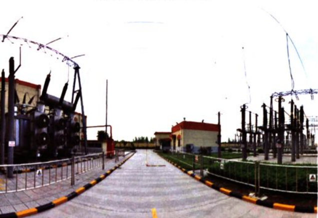
△220千伏营丘变电站
