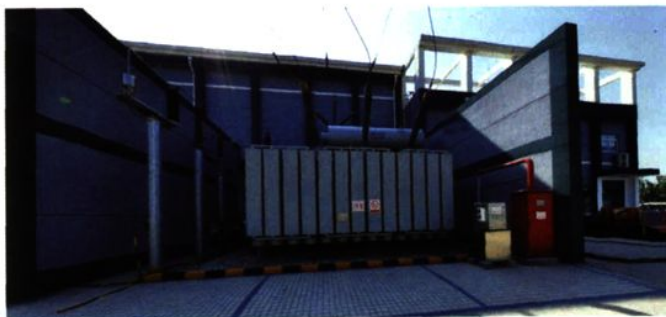
△220千伏惠泮变电站
