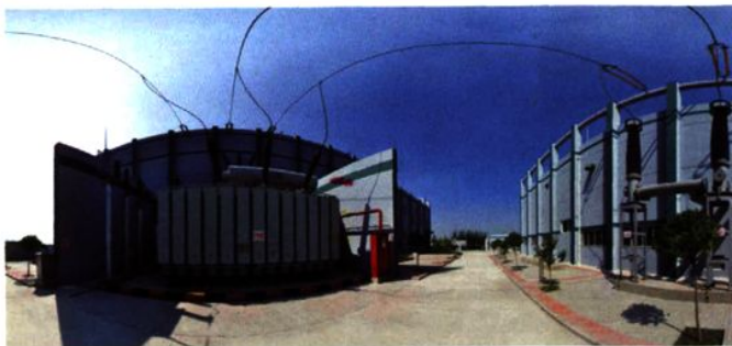
△220千伏齐林变电站
