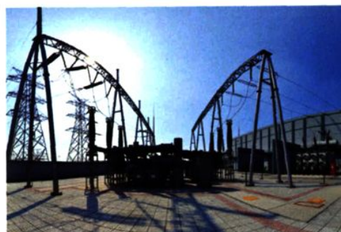
△220千伏果里变电站
