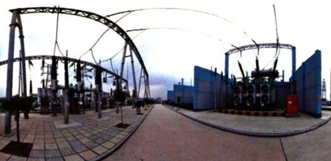
△220千伏冲山变电站
