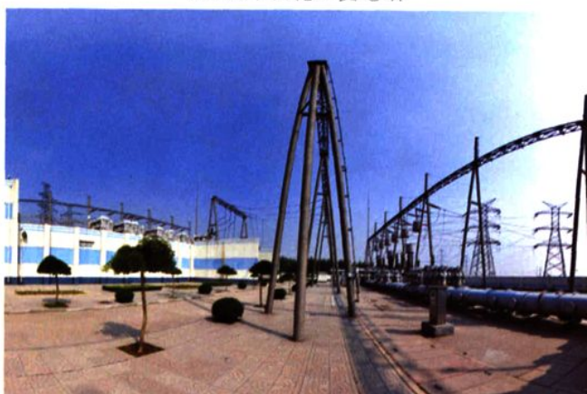
△220千伏金岭变电站
