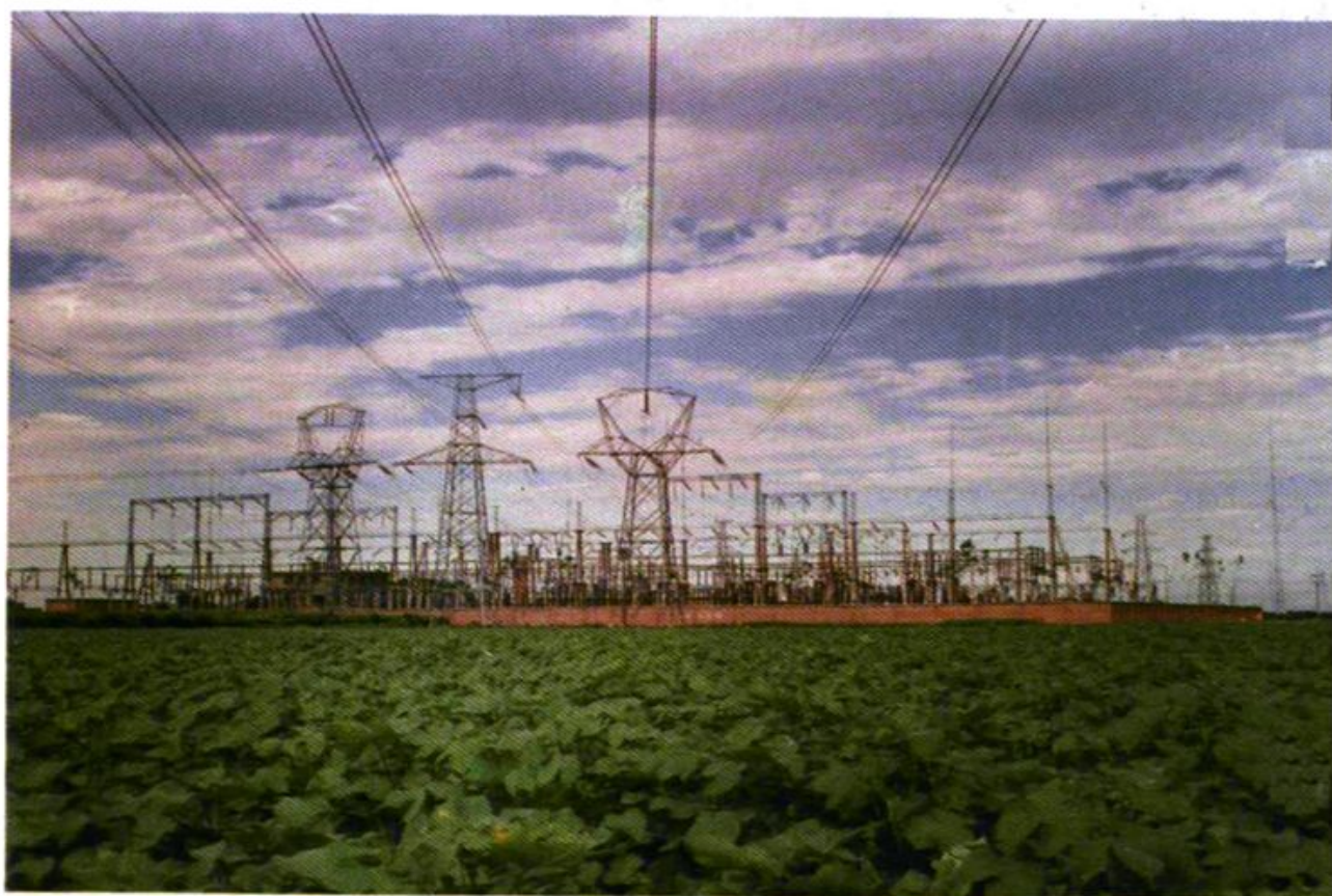
南郊220千伏变电站
