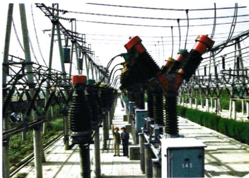
220千伏变电站巡视
