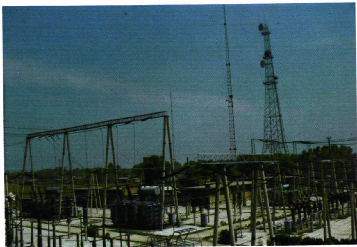
高碑店220千伏变电站
