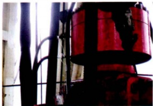
图 1-1-19 液压管线接口泄漏
