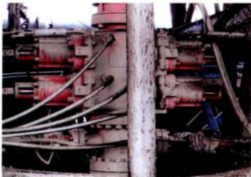
图 1-1-4 液压管线接口面向井架大门
