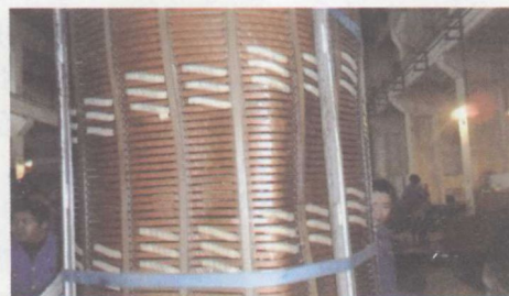
图 1-5 B相中压侧绕组外凸变形
