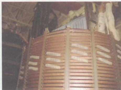
图 1-3 三相中压侧绕组的首端变形
