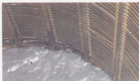
图 1-4 B相高压侧绕组下部存在匝间短路
