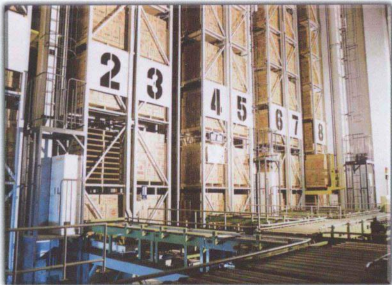
▲高24米，可容纳7.5万件的“楼上立库”一角
