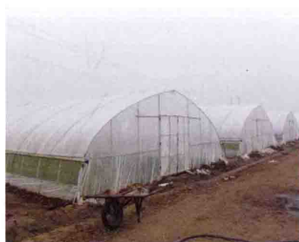
在钢管大棚上覆盖防虫网
