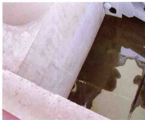
彩图 3 闸墩和底板裂缝(白色线状为裂缝表面修补痕迹)
