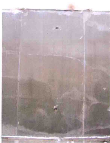
彩图 13 导流墙混凝土浇筑冷缝
