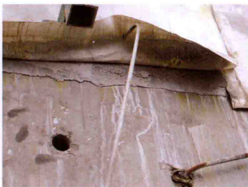
彩图 10 电站厂房混凝土施工出现错台挂帘
