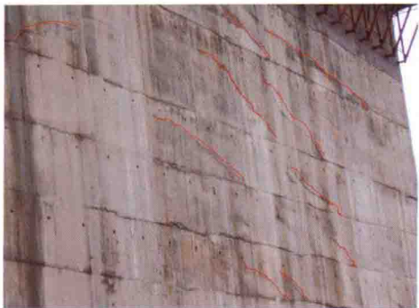
彩图 5 大型闸墩施工冷缝(图中红线示意)
