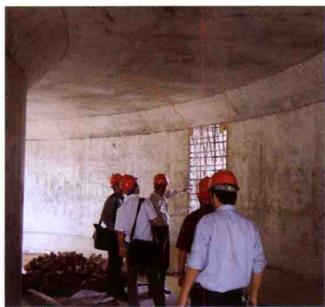
彩图 4 输水廊道顶板裂缝(图中红线示意)
