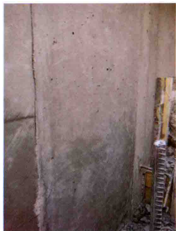
彩图 11 闸室边墙混凝土表面气泡
