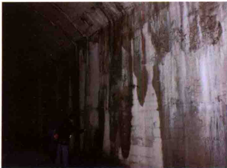
彩图 6 隧洞衬砌裂缝渗水
