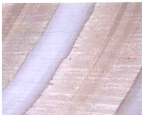
彩图 1 混凝土坝溢流面裂缝
