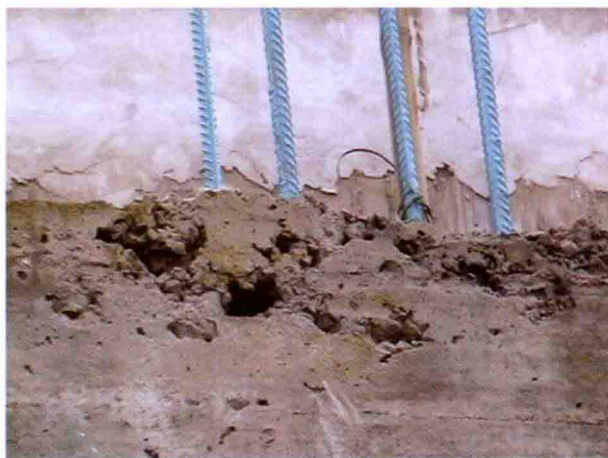
彩图 12 混凝土浇筑成型出现大量孔洞
