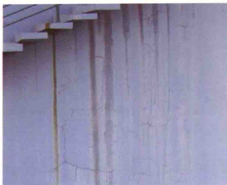
彩图 2 水电站闸门控制塔裂缝
