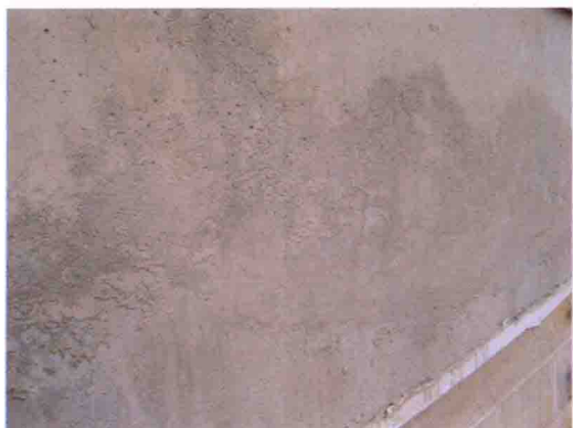
彩图 7 水闸边墙新浇混凝土麻面
