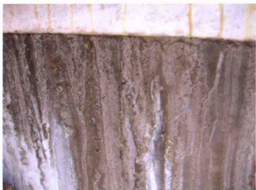
彩图 9 冲沙洞混凝土墙严重漏浆污染
