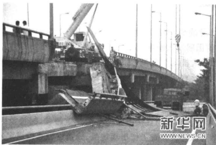
图 1-1-2 钱塘江大桥塌桥事件
