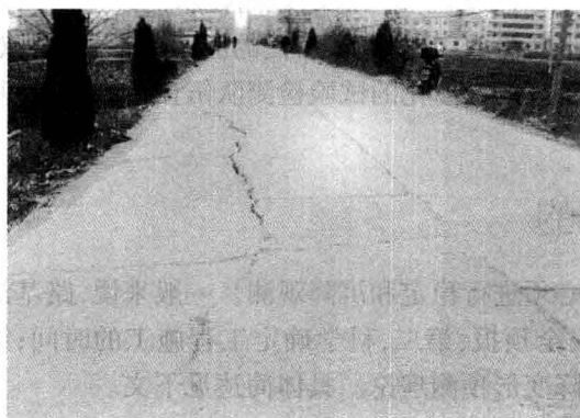
图 1-5 某公路路面裂缝一
