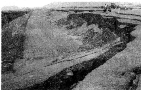
图 1-3 某高速公路路基失稳
