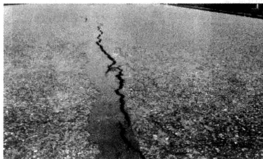
图 1-4 某公路桥引桥裂缝
