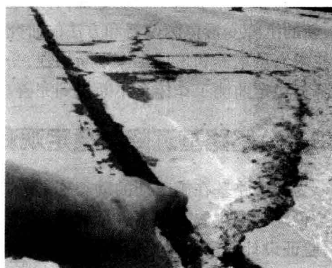
图 1-6 某公路路面裂缝二
