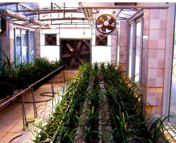
装置通风排气设施
