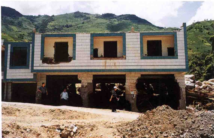
▶ 2001年7月，新平县遭受大暴雨袭击引发泥石流，图为腰街电信机房受损情况。(云南省电信公司 供)
