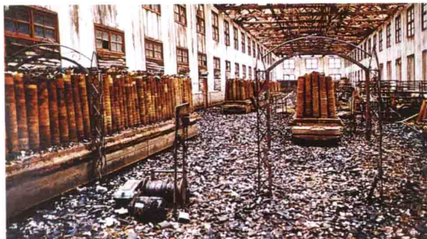
◀ 2000年永胜“6·20”特大冰雹灾害，永胜县瓷厂遭毁灭性打击，直接经济损失达1100多万元。图为该厂严重受损的车间惨状。(丽江行署 供)
