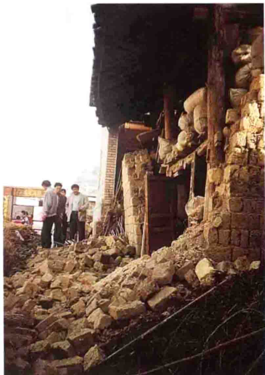
▲ 2001年4月12日，施甸县境内发生5.9级地震，图为民宅倒塌、地基断裂实况。（保山市 供）
