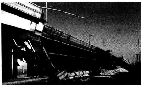
图 1-5 哈尔滨阳明滩大桥引桥坍塌现场
