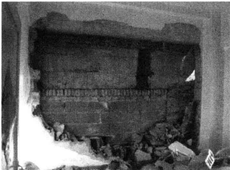
(a) 抗震缝宽度不够，相邻两栋建筑地震时相互碰撞，导致其中一栋建筑的填充墙倒塌
