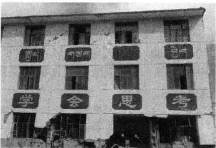
(b) 西侧结构碰撞产生的斜裂缝清晰可见
