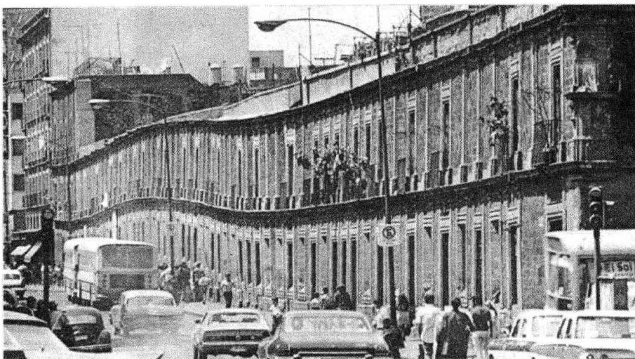
图 0-5 墨西哥城某建筑物不均匀沉降
