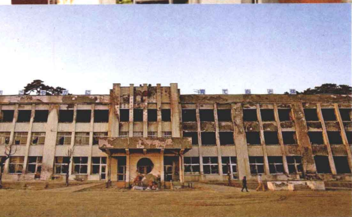
在“3·11”大地震中受到破坏的日本小学
