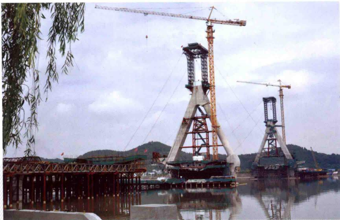
川建H3-36B固定式塔吊
