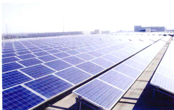
荣威 3MW 屋顶光伏电站项目
