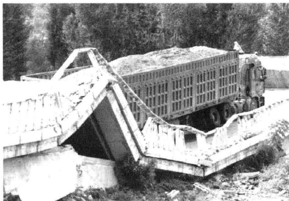
图1-8 车辆荷载过大压垮桥梁
