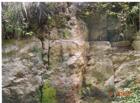
图 1.6 砂岩层面裂隙
