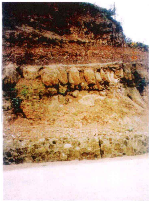
图 1.7 向斜轴部砂岩层间裂隙
