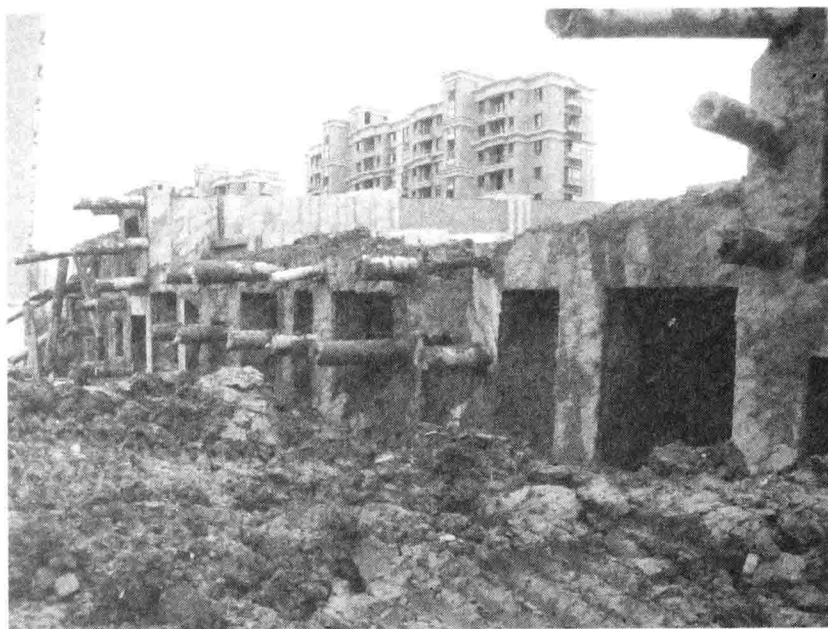
图 1-2 上海“莲花河畔景苑”倒塌楼房桩基破坏情况
