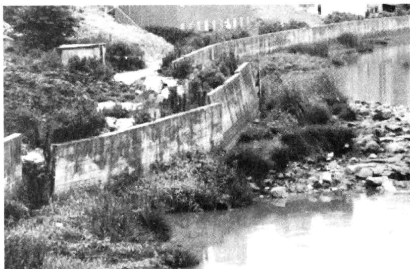
图 1-3 上海“莲花河畔景苑”北侧防汛墙位移情况
