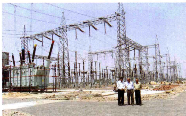
图 16 印度电网公司变电站(在印度加尔各答附近),在这里安装了光纤布拉格光栅(FBG)温度传感器。
