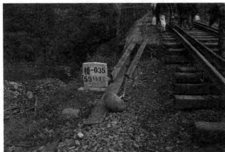
图 17 广岳铁路某桥台后填土下沉
