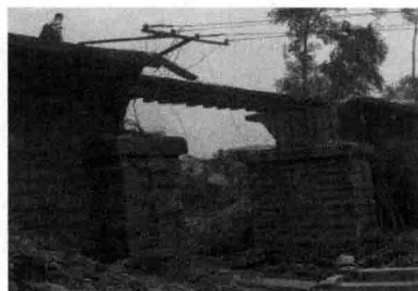
图4 广岳铁路化肥厂中桥出现落梁
