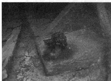
图7 锚固螺栓弯曲
