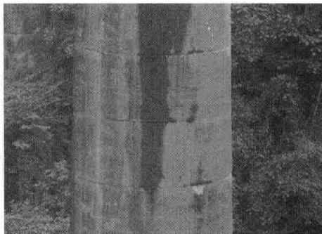
图6 桥墩沿施工缝的剪切破坏
