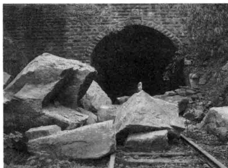
图 19 广岳铁路某隧道进口段落石上道
