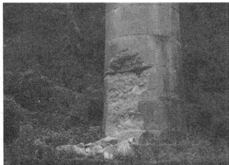
图5 桥墩开裂与剥落
