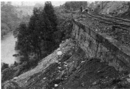
图 18 局部挡土墙破坏
