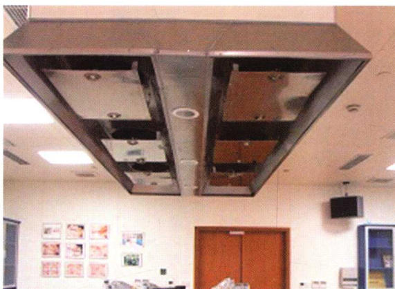
图 1-7 强排风空气净化系统
