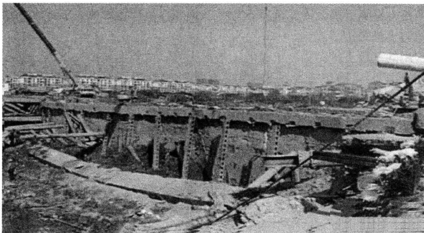
图 1-1 杭州地铁湘湖站工程事故现场照片
