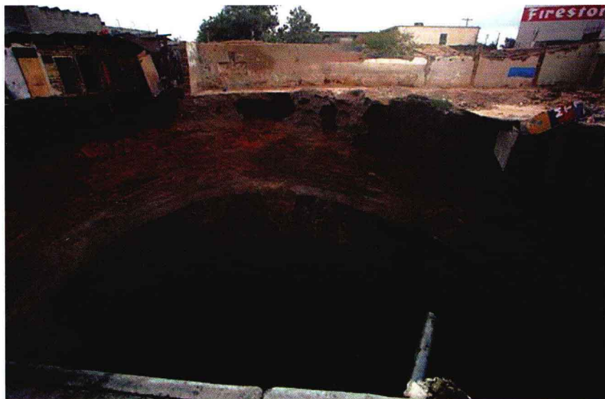
塌陷会引发小范围的地面震动
