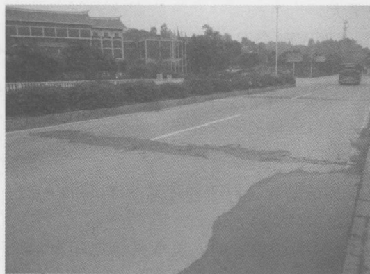
图 1-5 某桥桥面连续处破损照片
