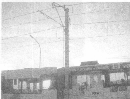
◆有轨电车的供电架
