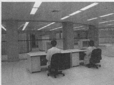
图 1-9 曙光 4000A 监控中心
