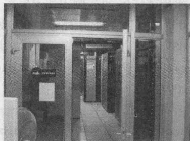
图 1-10 曙光 4000A 机房入口
