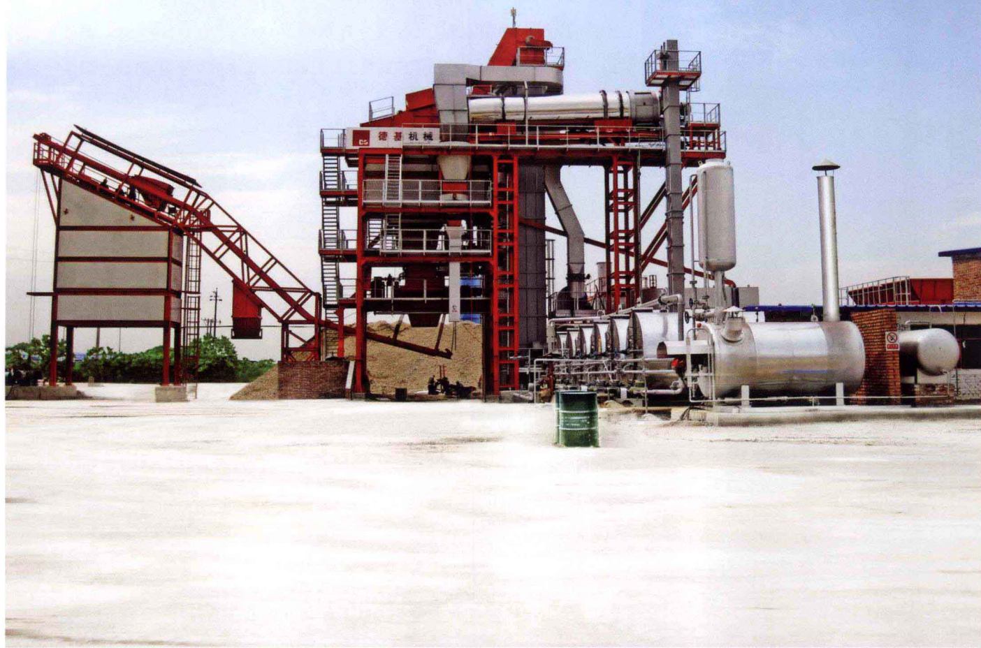
废旧沥青混合料再生利用搅拌设备
