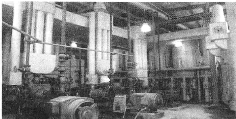
图 1-3 冷库压力管道外观
