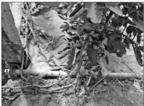
图 29 古浪县海字滩镇李家窝村 PVC 引水管
