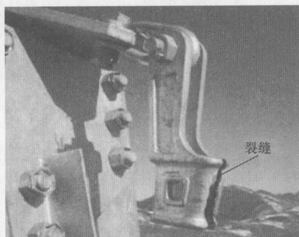
图 1-1 楔型耐张线夹凸肚侧开裂
