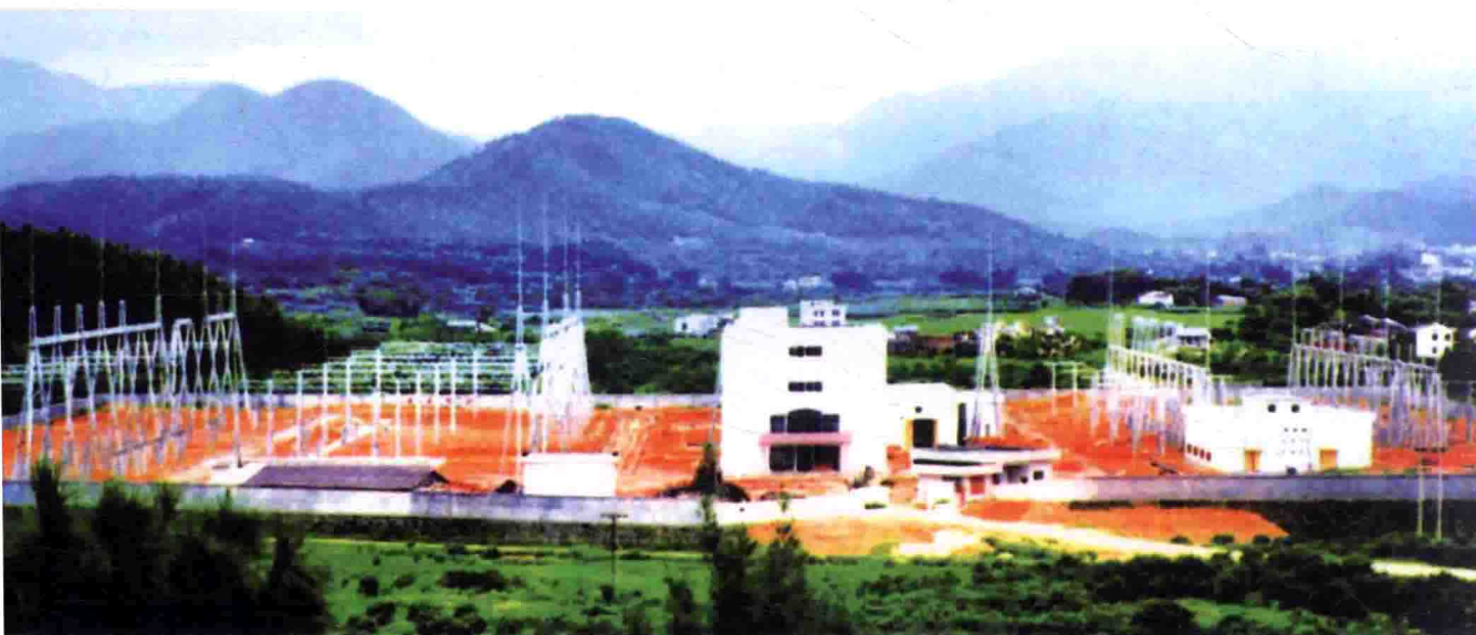
▲ 汤坑220千伏输变电站（2003年12月31日投产）
