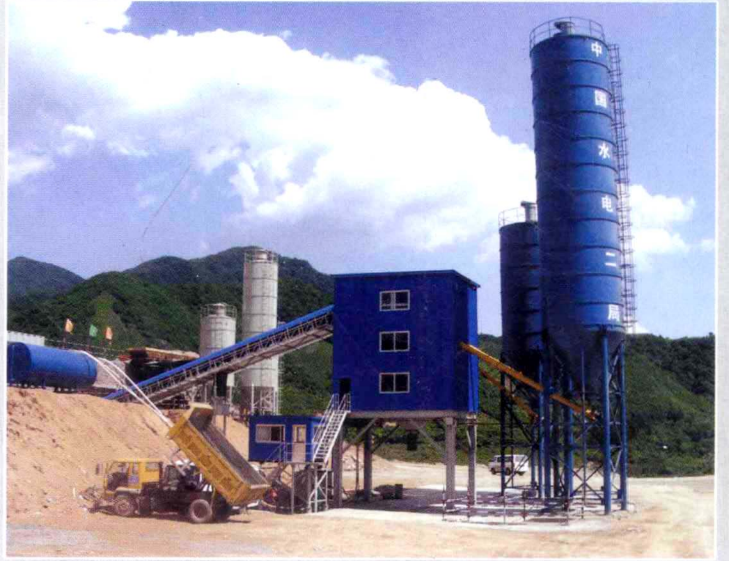
工程混凝土搅拌站
