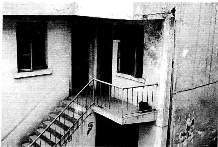
照片4 墙皮斑驳的秦窑法庭干警食堂
